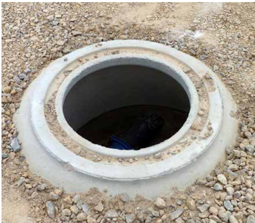
Cono de alcantarillado.
